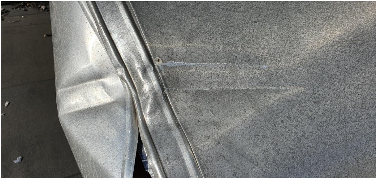
Figur 5-25: Skade på luftekanal (nærbilde). Bilde fra 11. august.
