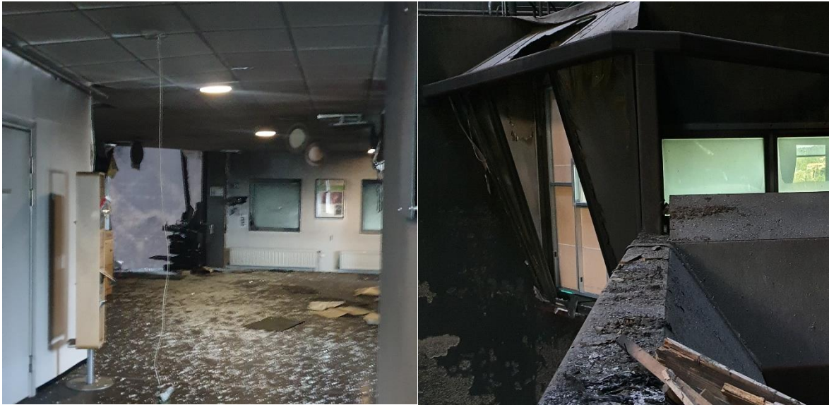
Figur 5-14: Skrått observasjonsvindu inn mot bunkeren var slått inn, mindre sidevinduer intakte. Venstre: Bilde fra kontrollrom 29.06. Høyre: Bilde fra bunkerrom 11.08 (vindu provisorisk erstattet).
