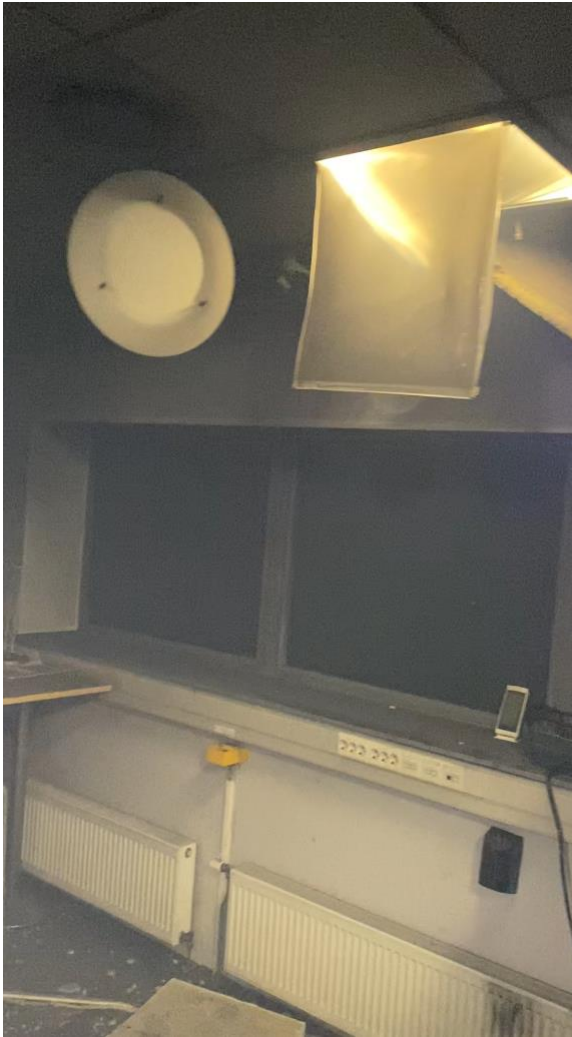
Figur 5-18: Takplater nær vinduer mot bunker har løsnet. Stillbilder fra video møterom (venstre) og kjøkken (høyre). Bilder fra video natt til 25.06.
