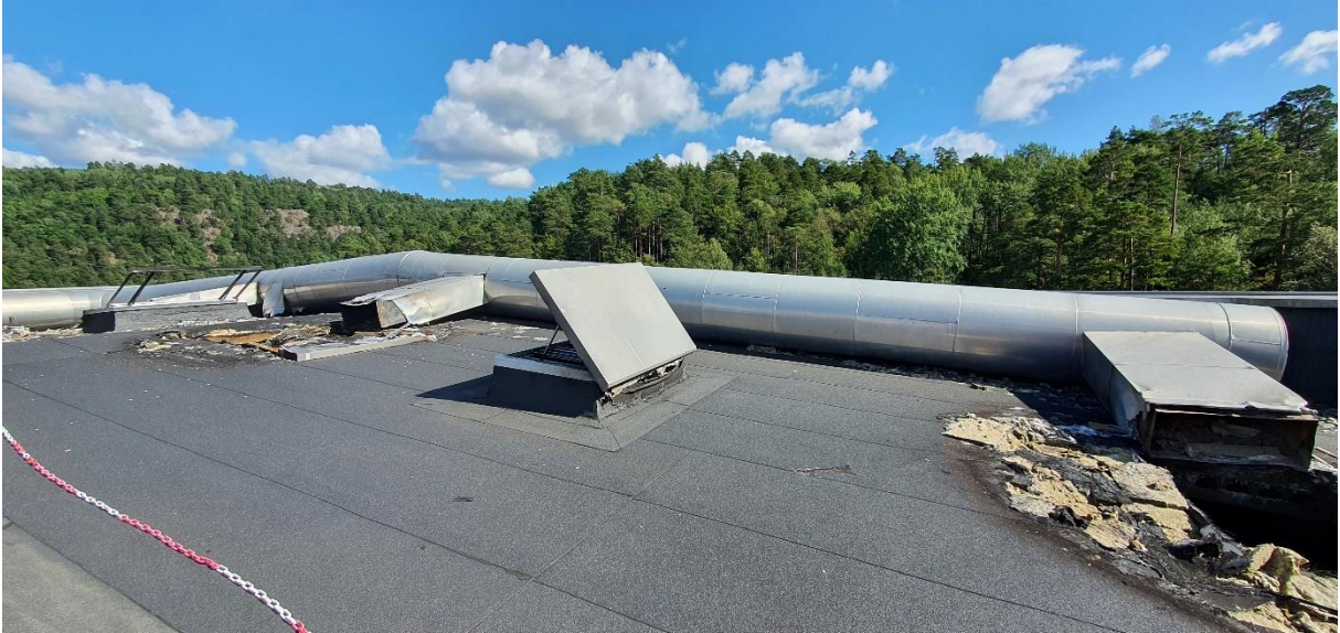
Figur 5-23: Påkoblingspunkt for luftesystem er ødelagt. Bilde fra 11. august.
