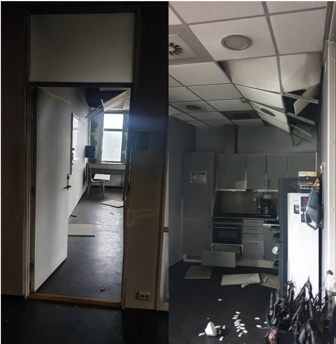
Figur 5-17: Takplater har løsnet i møterom (venstre) og kjøkken (høyre). Bilder fra 29.06.
