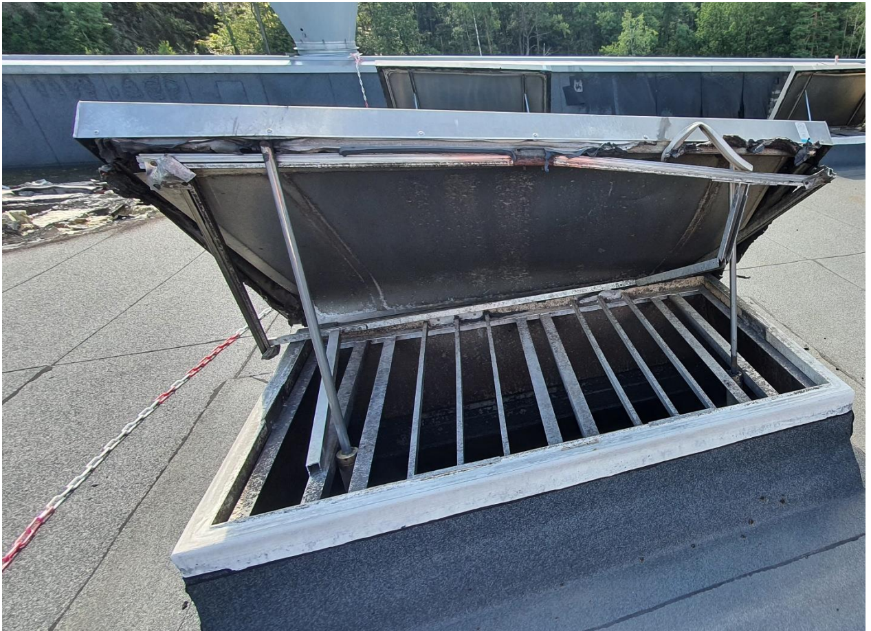
Figur 5-20: Takluke med skade i innfestning. Bilde fra 11. august.
