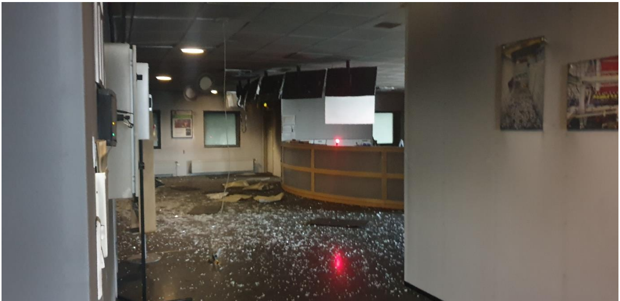
Figur 5-16: Skjermer i taket, og de fleste takplater, er på plass. Bilde fra 29.06.
