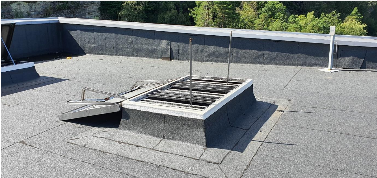
Figur 5-27: Luke som er revet av innfestningen. Bilde fra 11. august.
