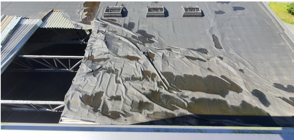
Figur 5-21: Skade i tak over tømmestasjoner. Bilde fra 11. august.
