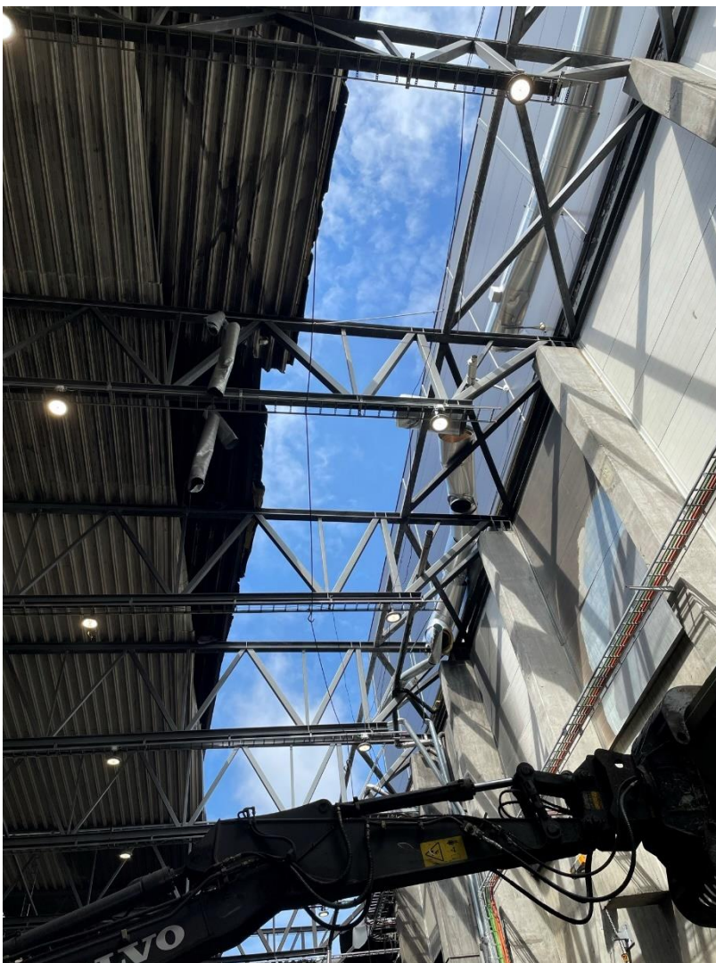
Figur 5-22: Skade i tak over sidetipp. Bilde fra 25.juni.
