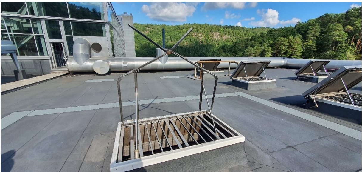
Figur 5-26: Mulig utgangspunkt for prosjektiler mot luftekanal. Bilde fra 11. august.
