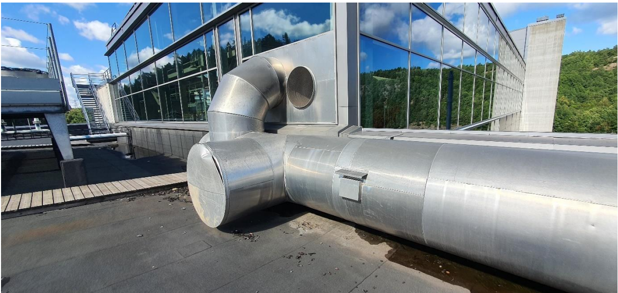
Figur 5-24: Skade på luftekanal (oversikt). Bilde fra 11. august.
