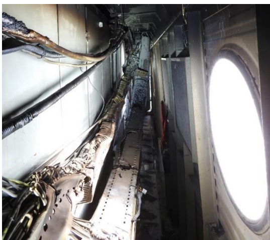
Figur 18: Brente kabler i maskinrom. Foto: SHK
