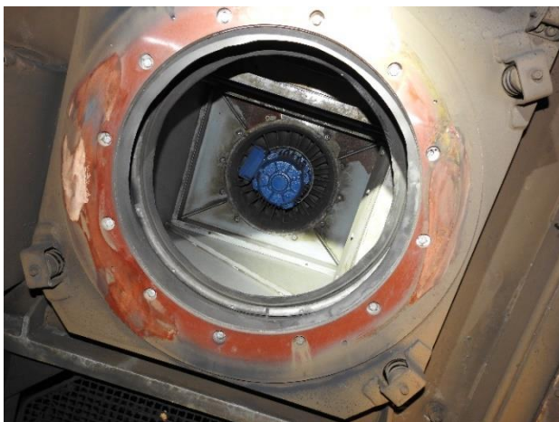
Figur 21: Innvendig i ventilatorsjakt. Foto: SHK
