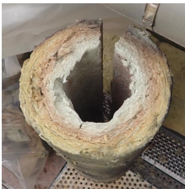
Figur 19 Tverrsnitt av brannpåvirket varmeisolasjon for overliggende rørlinje PL-13-0718. Bilde: Equinor
