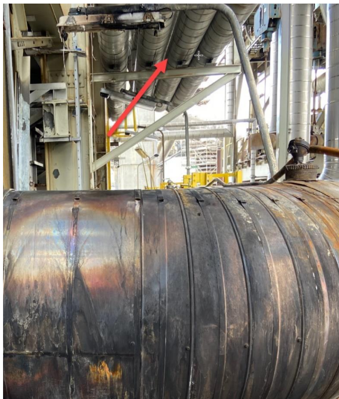
Figur 18 Bilde som viser PG-14-0204 og overliggende rørgate rett over lekkasjepunktet. Kilde Equinor
