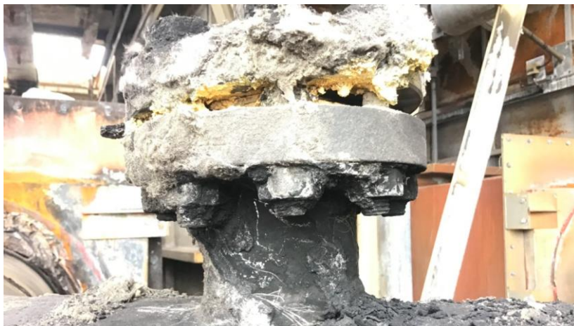
Figur 14 viser 2" termolommefflens etter branntilløpet. Kilde Ptil
