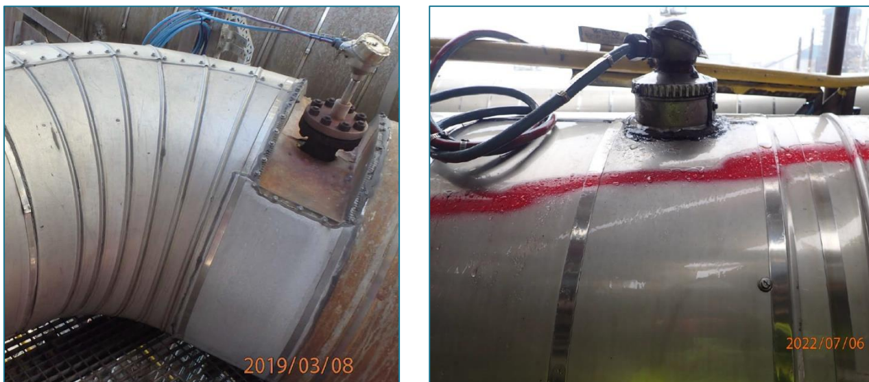
Figur 10 Bilder som viser termolommer på linjer mellom reaktor og ovner med og uten isolert flens. Foto: Equinor
